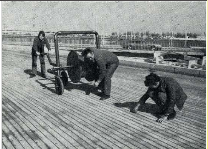
1968, Installation des Heizbandes auf einer Zufahrtsrampe zu einem Busparkplatz, Flughafen Orly bei Paris ( Elektrische Fußbodenheizung, von Robert Félix, 1971, Ultimheat Museum* )
